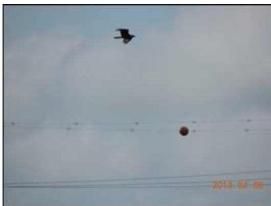
Ave em sobrevoos sobre cabos de Linha de Transmissão que possui sinalizadores para avifauna.
