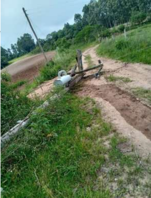
Foto 5 - Poste caído devido ao evento em Chuvisca (2023-849986)
