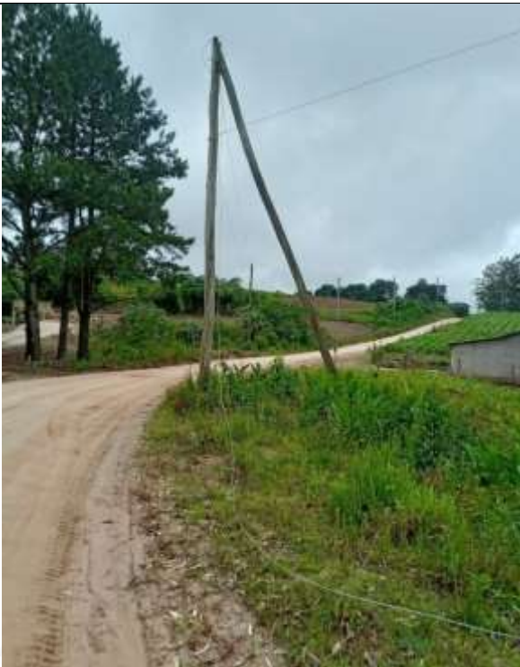
Foto 7 - Condutores arreventados devido ao evento em Sentinela do Sul (2023-849309)
