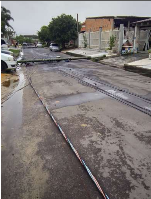
Foto 7 – Poste caído devido ao evento em Capão da Canoa (2023-834198)
