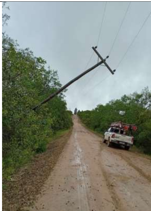
Foto 2 – Poste tombado devido ao evento em Pinheiro Machado (2023-832544)
