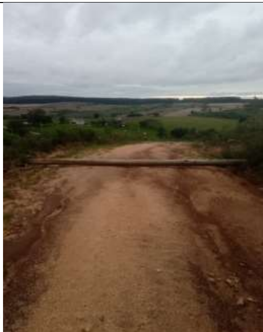
Foto 3 – Poste caído devido ao temporal em Pinheiro Machado (2023-832544)
