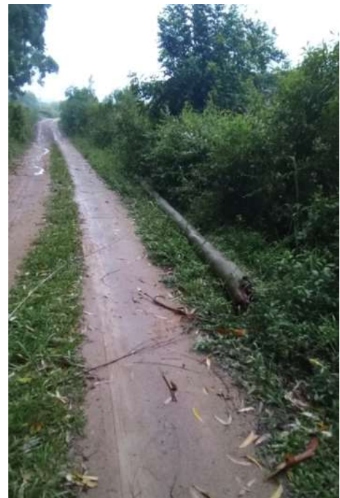
Foto 8 – Poste caído devido ao evento em Dom Feliciano (2023-832840)
