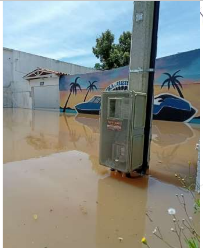
Foto 22 - Área alagada em Eldorado do Sul – ocorrência 2023-825769
