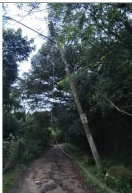
Foto 6 – Poste tombado, devido ao evento, em Porto Alegre – RS
