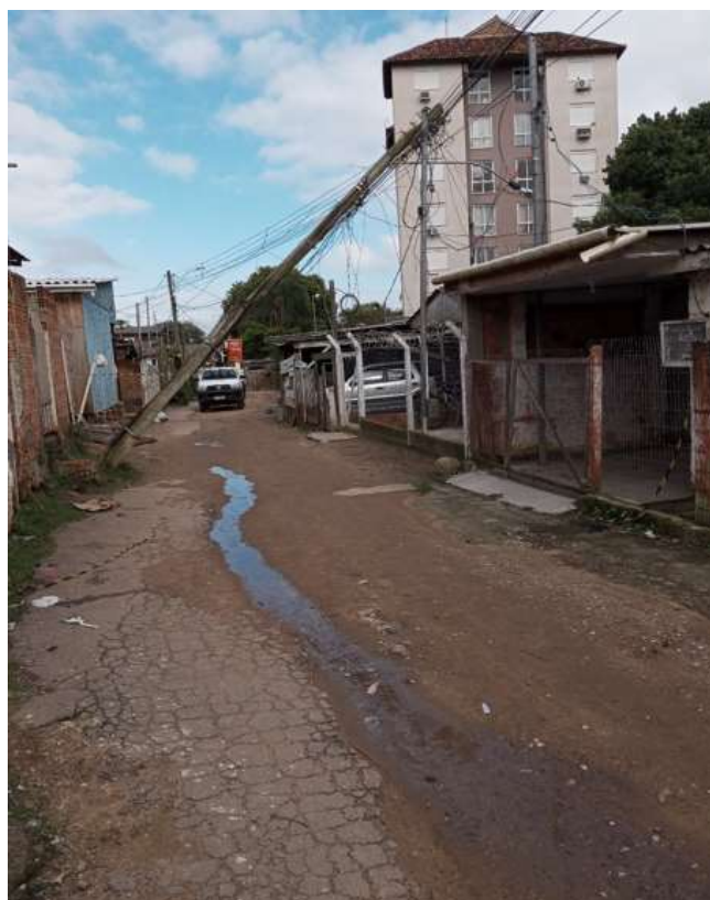
Foto 2 – Poste tombado, devido ao evento, em Porto Alegre – RS
