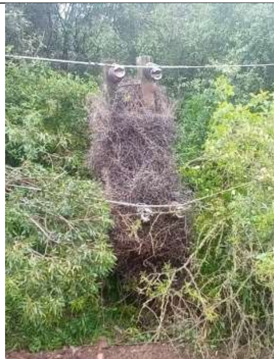
Foto 4 – Poste caído, devido ao evento, em Bagé – RS
