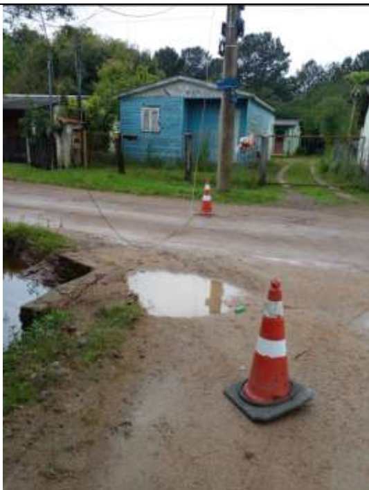
Foto 3 – Condutor caído, devido ao evento, em Porto Alegre – RS
