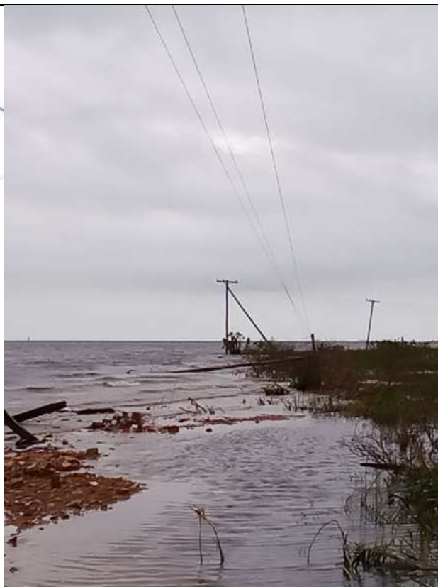
Foto 9 – Poste caído, devido a inundação, em Pelotas
