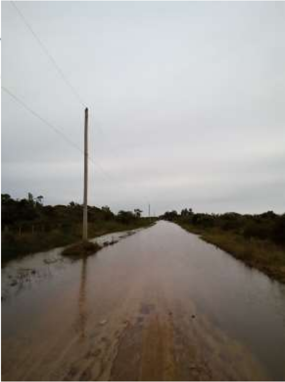
Foto 1 - Estrada alagada, dificultando o acesso, em Arambaré - RS
