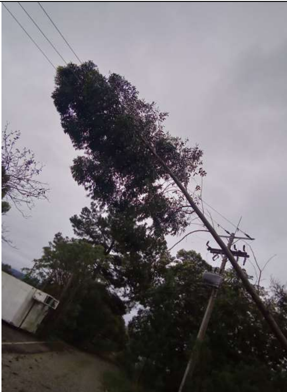
Foto 7 – Árvore sobre a rede, devido ao evento, em Canguçu
