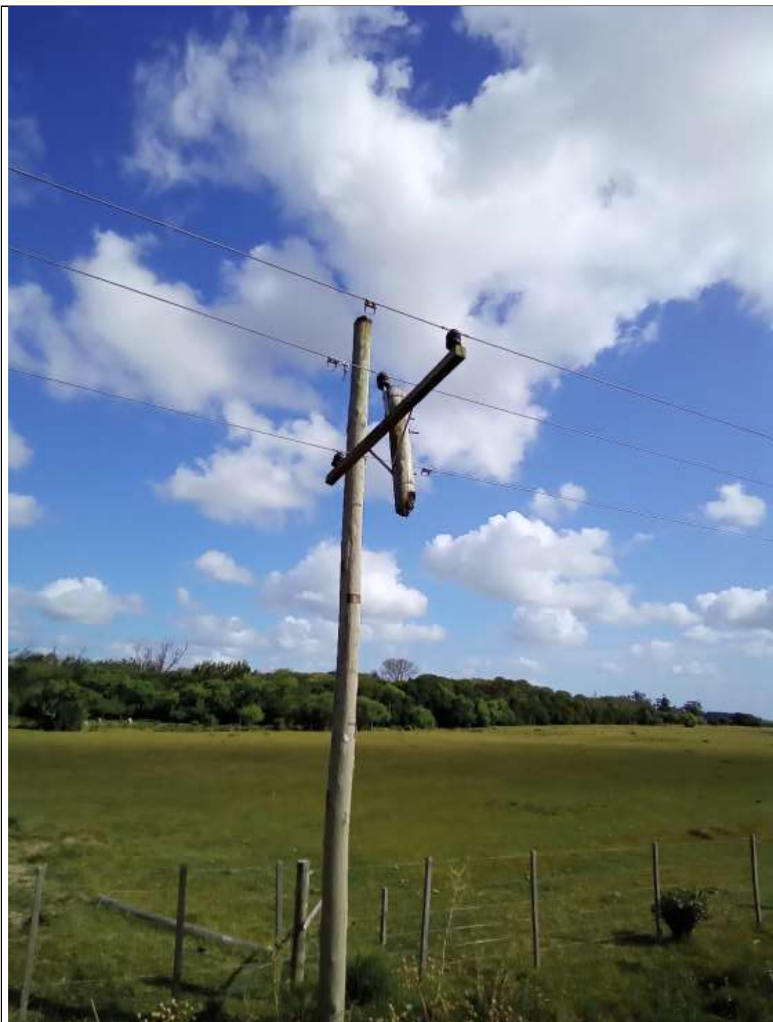
Foto 6 – Poste quebrado devido ao temporal em Santa Vitória do Palmar – RS
