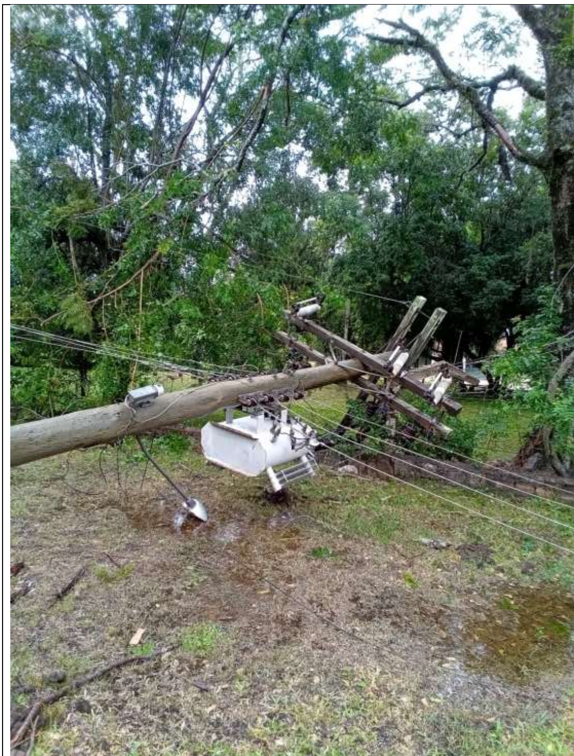
Foto 3 – Poste caído devido ao temporal em Camaquã – RS
