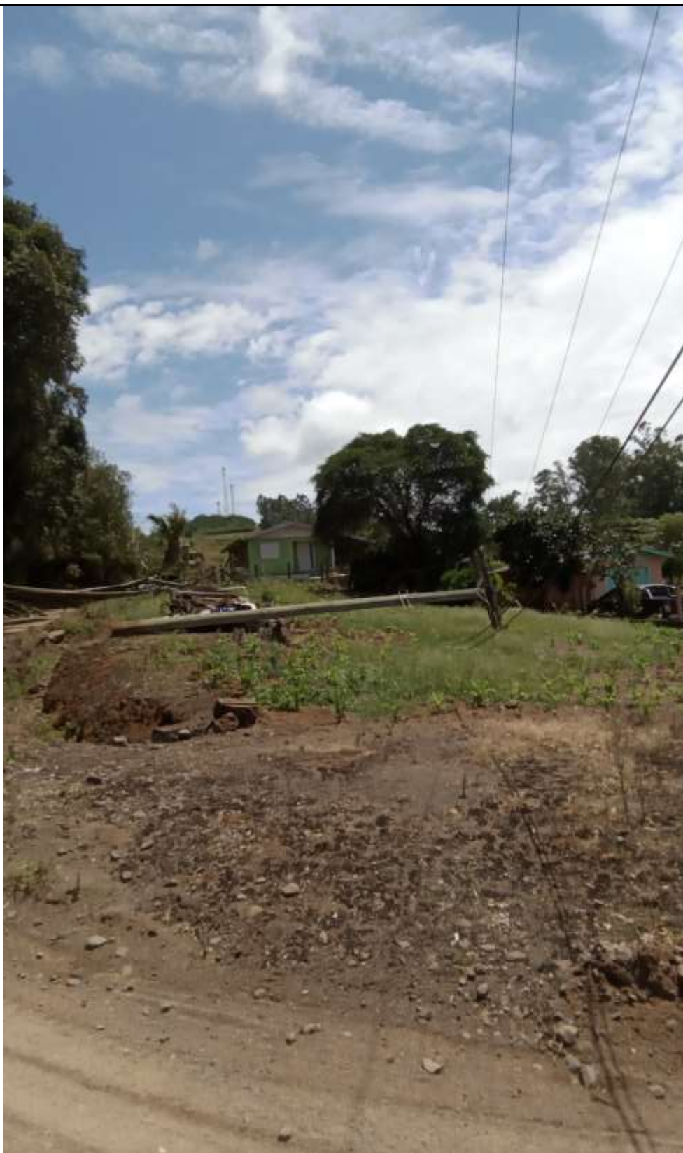
Foto 8 – Poste caído devido ao temporal em Caraá – RS
