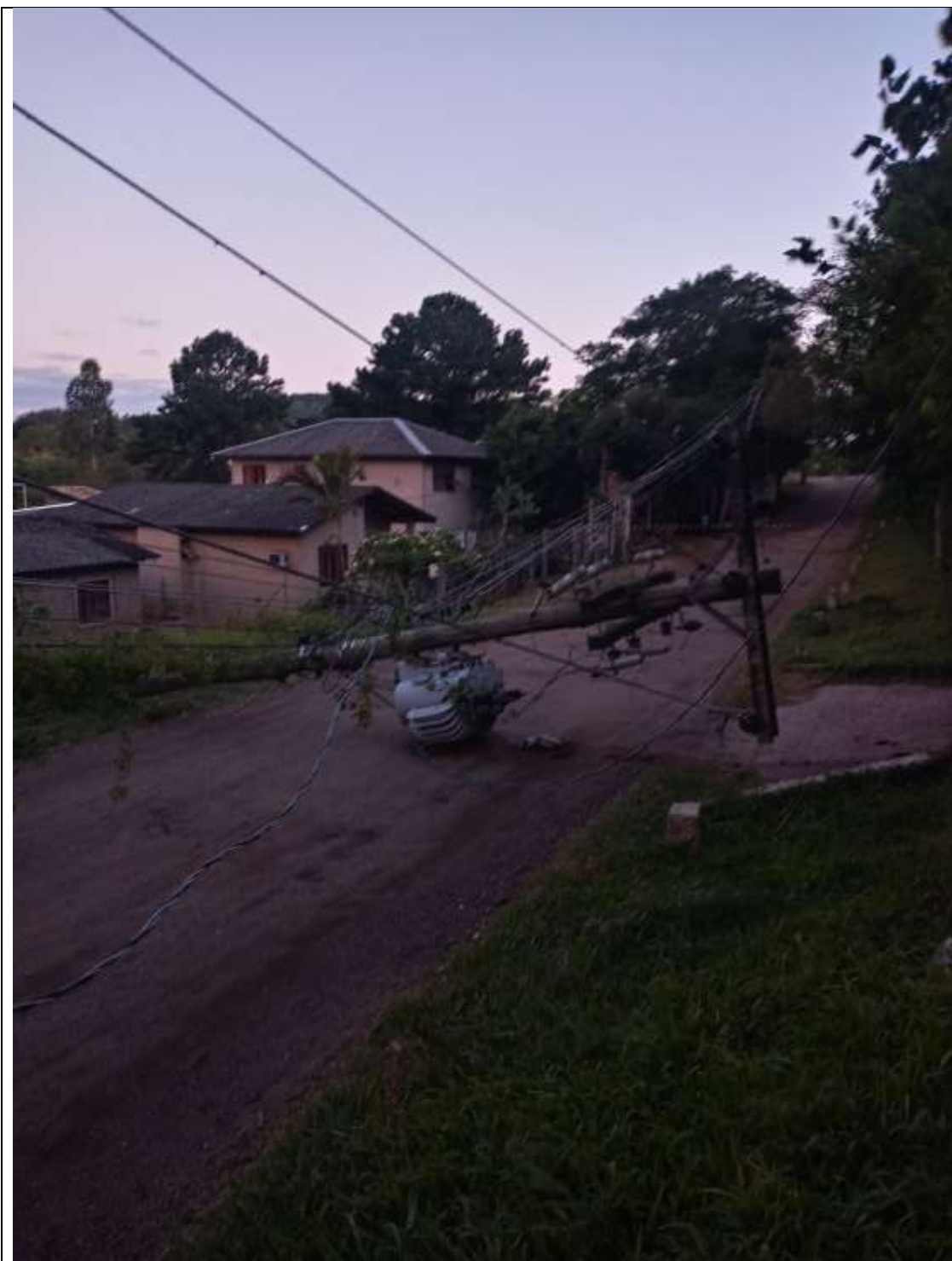
Foto 11 – Poste caído devido ao temporal em Porto Alegre – RS
