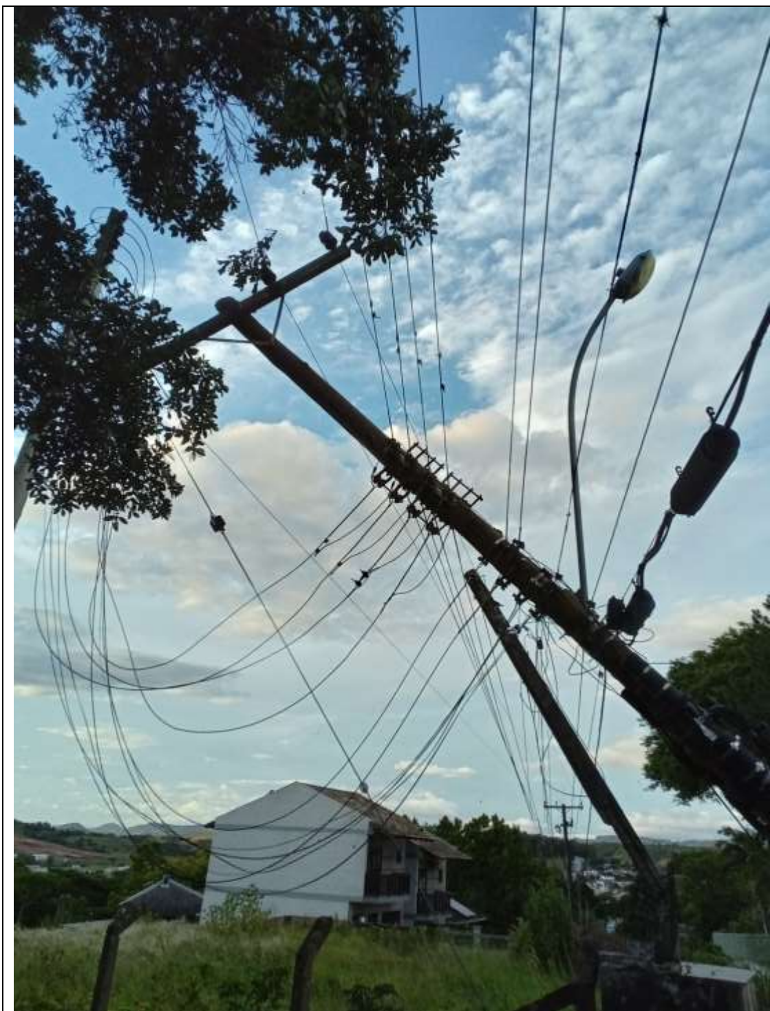
Foto 7 – Poste tombado devido ao temporal em Santo Antônio da Patrulha – RS
