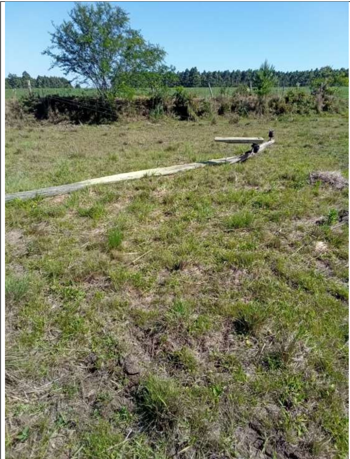
Foto 8 – Poste caído devido ao temporal em Eldorado do Sul – RS
