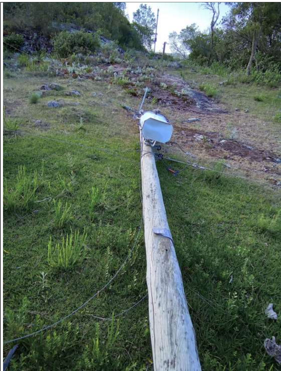
Foto 4 – Poste caído devido ao temporal em Canguçu - RS
