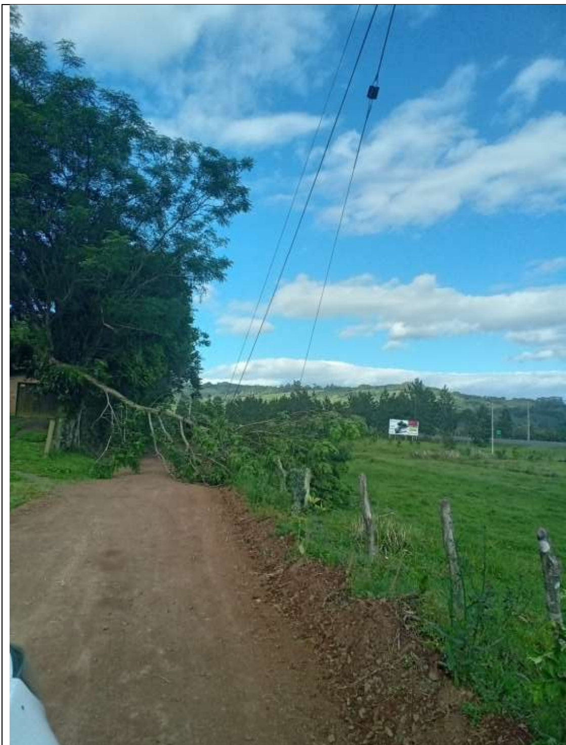
Foto 6 - Árvore caída sobre a rede devido ao temporal em Dom Pedro de Alcântara – RS
