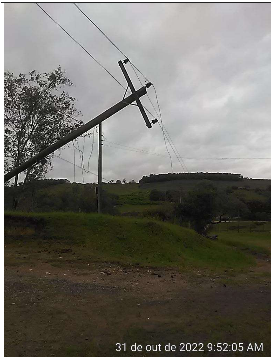
Foto 6 – Poste tombado devido ao temporal em Pelotas – RS
