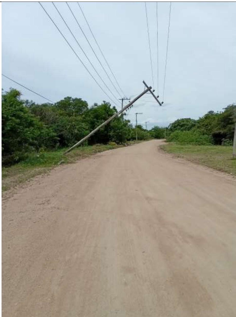
Foto 2 – Poste tombado devido ao temporal em Camaquã – RS
