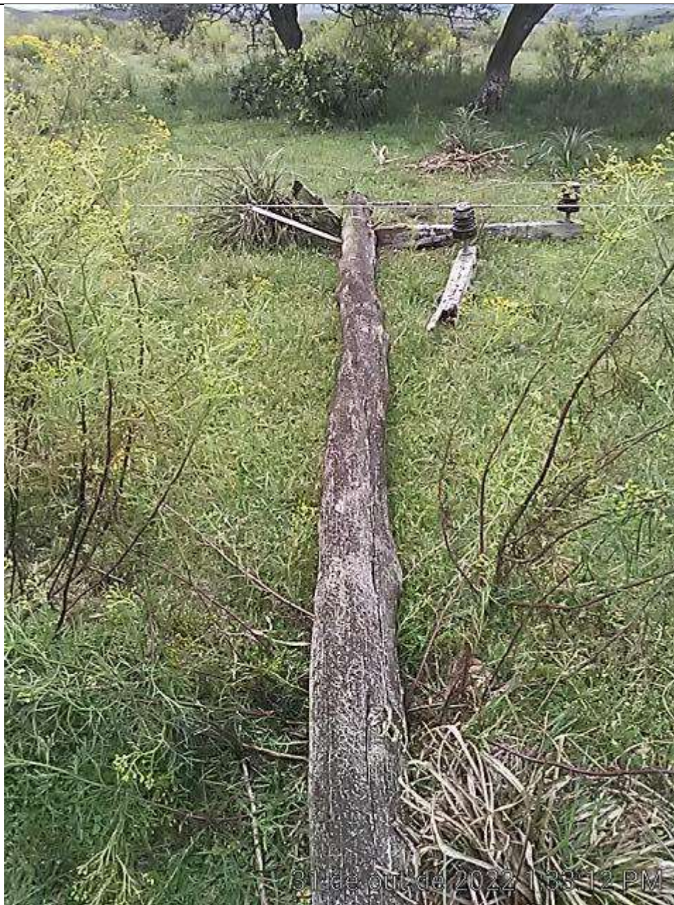
Foto 1 – Poste caído devido ao temporal em Bagé - RS
