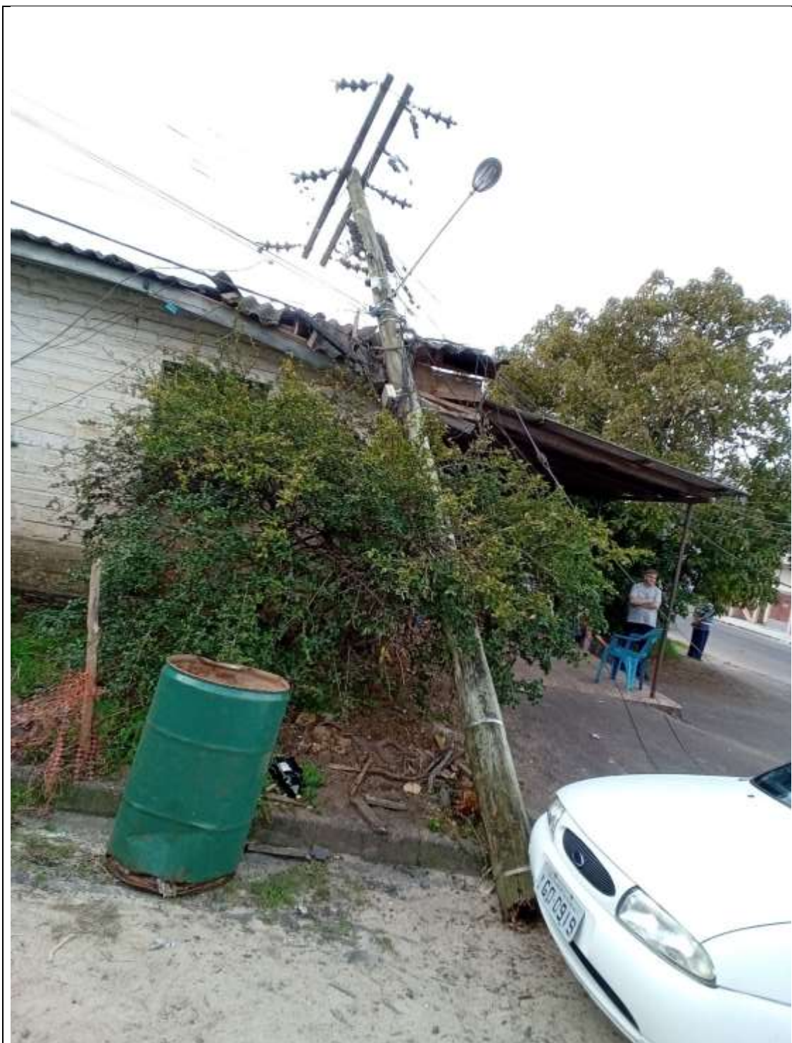
Foto 4 – Poste caído devido ao temporal em Santo Antônio da Patrulha – RS
