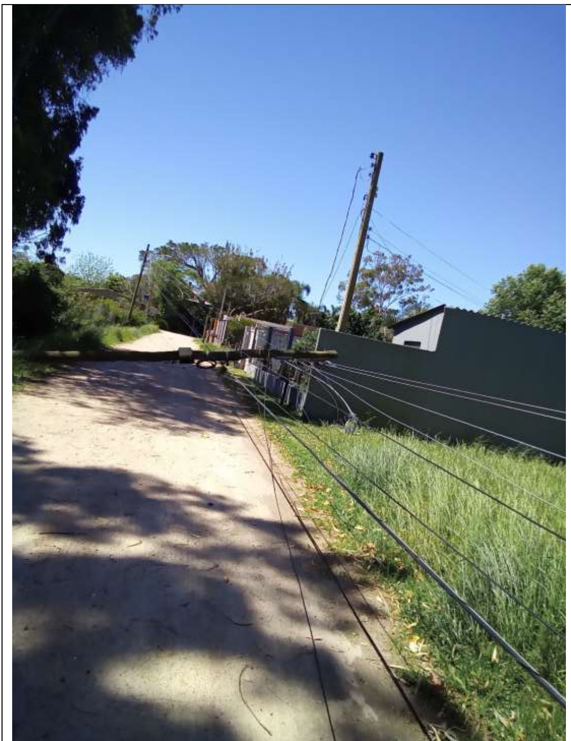
Foto 3 – Poste caído devido ao temporal em Rio Grande - RS
