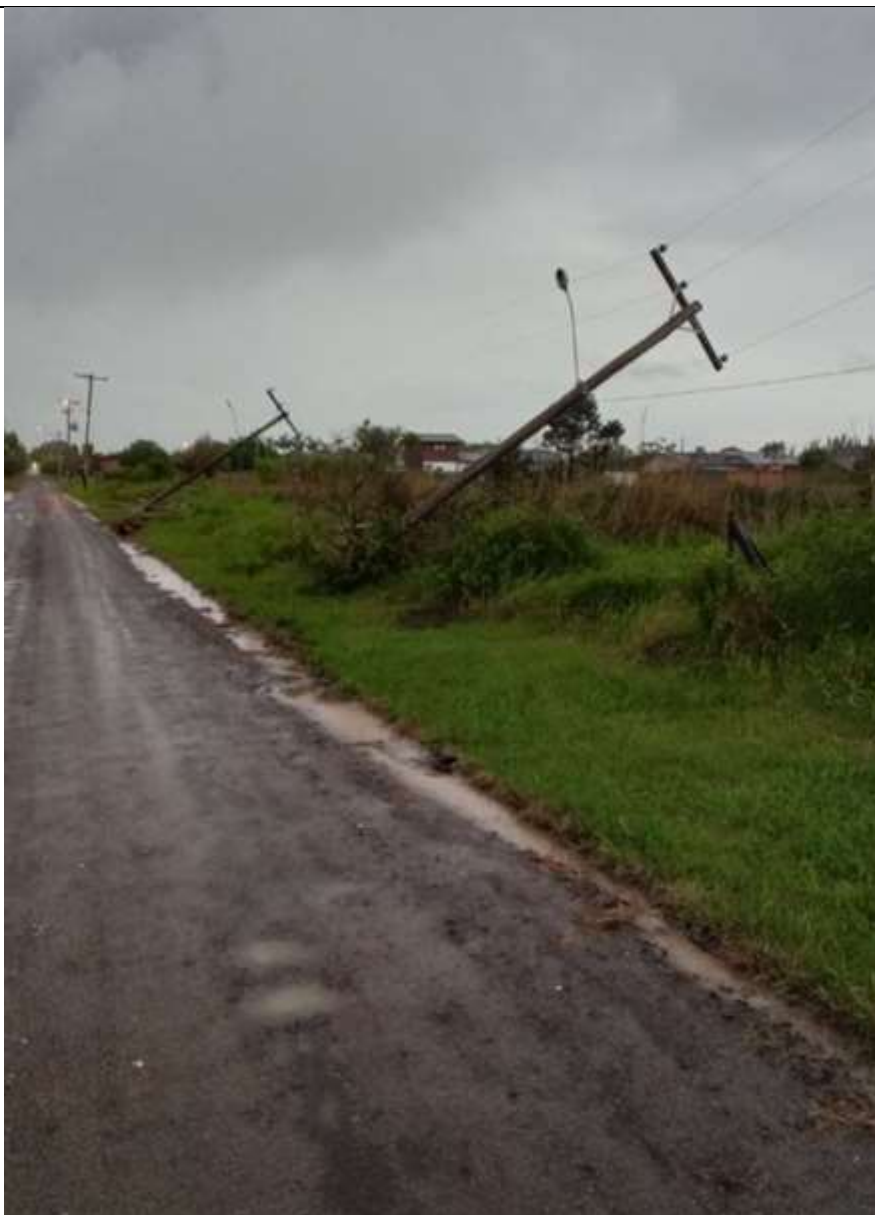
Foto 2 – Postes tombados devido ao temporal em Capão da Canoa – RS
