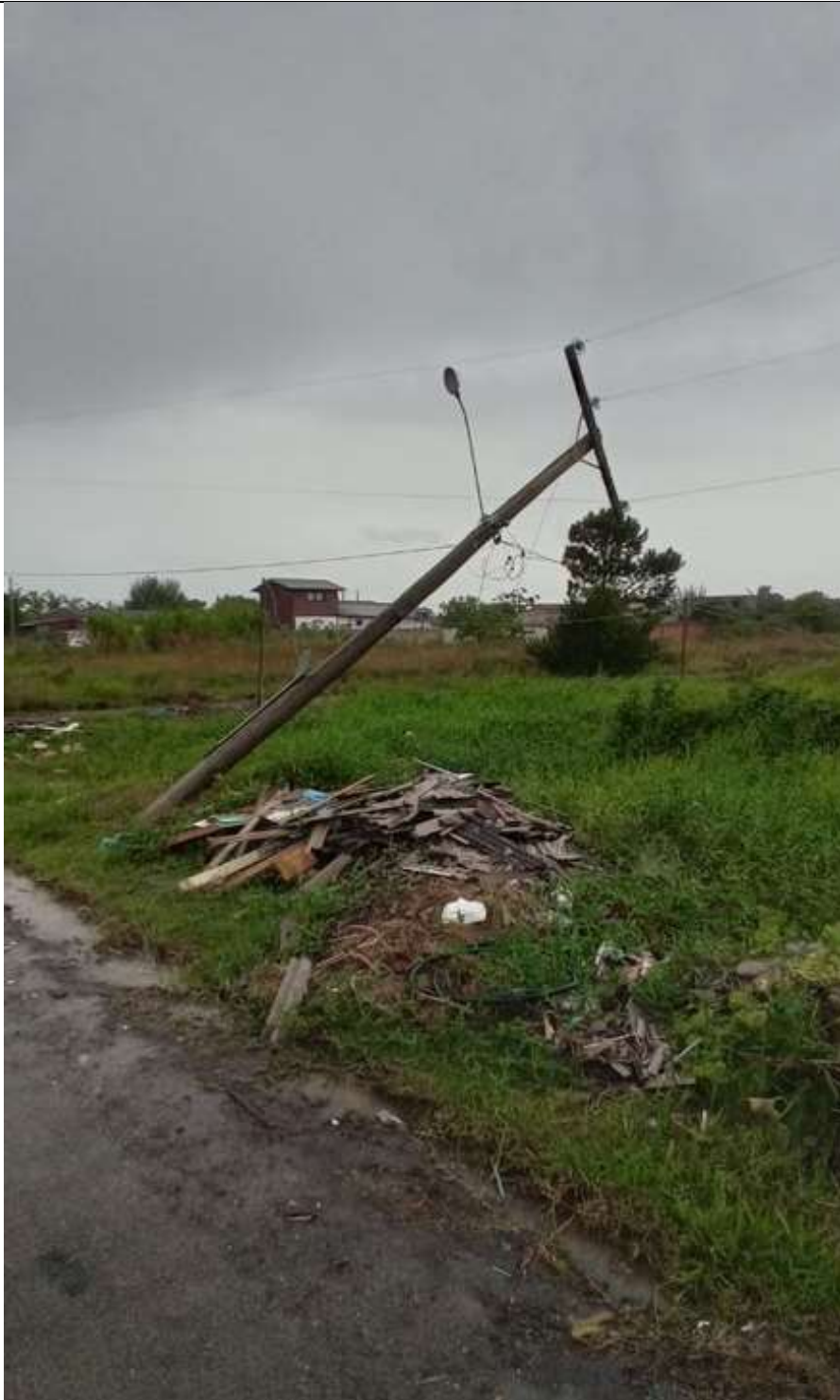
Foto 1 – Poste tombado devido ao temporal em Capão da Canoa – RS
