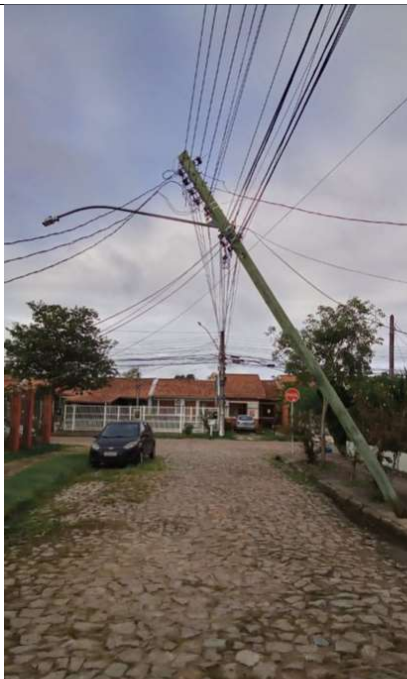
Foto 5 – Poste tombado devido ao temporal em Porto Alegre – RS
