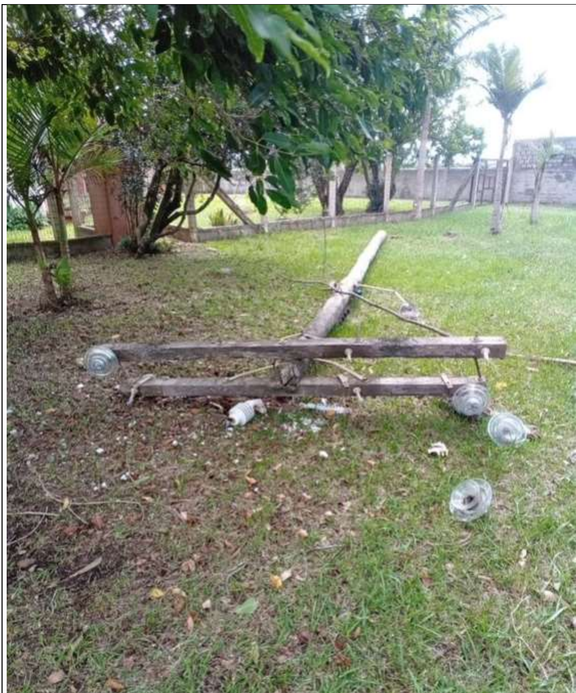
Foto 3 – Poste caído devido ao temporal em Terra de Areia – RS
