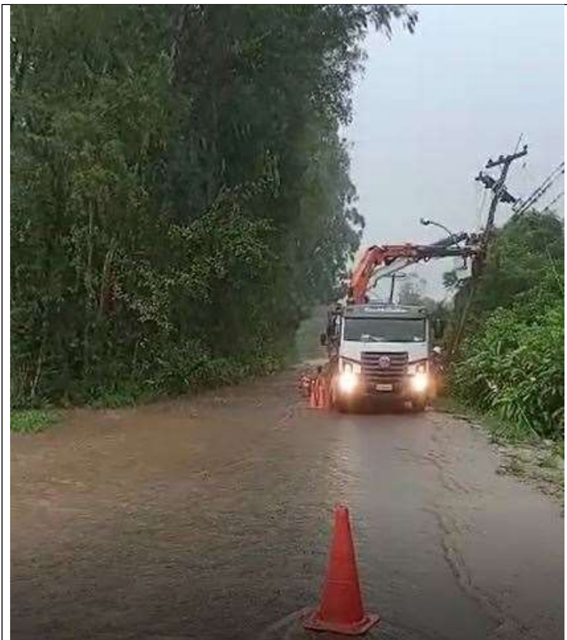
Foto 4 – Atendimento realizado em meio a rua alagada em Três Forquilhas – RS
