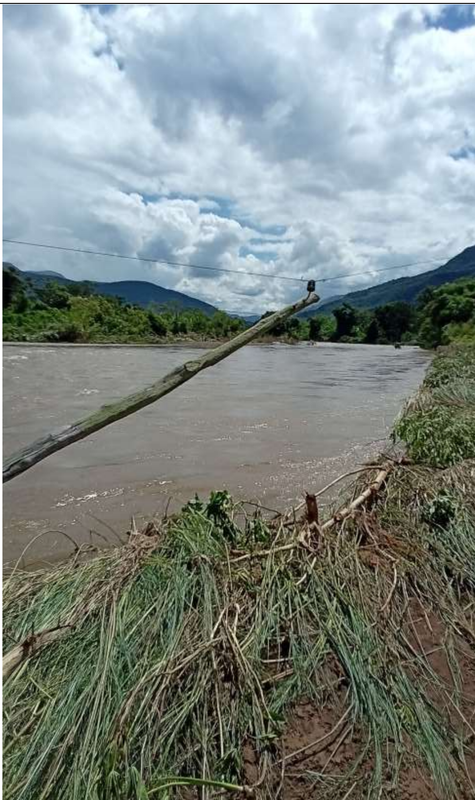
Foto 3 – Poste tombado devido à cheia do rio em Itati – RS
