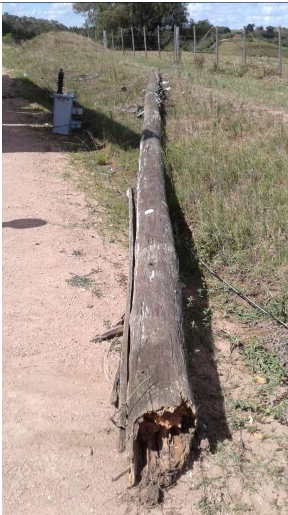
Foto 9 – Poste caído devido ao temporal em Canguçu – RS
