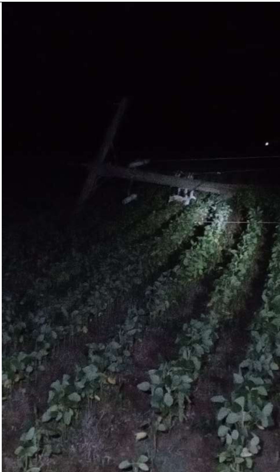
Foto 7 – Poste caído devido ao temporal em Pedras Altas – RS
