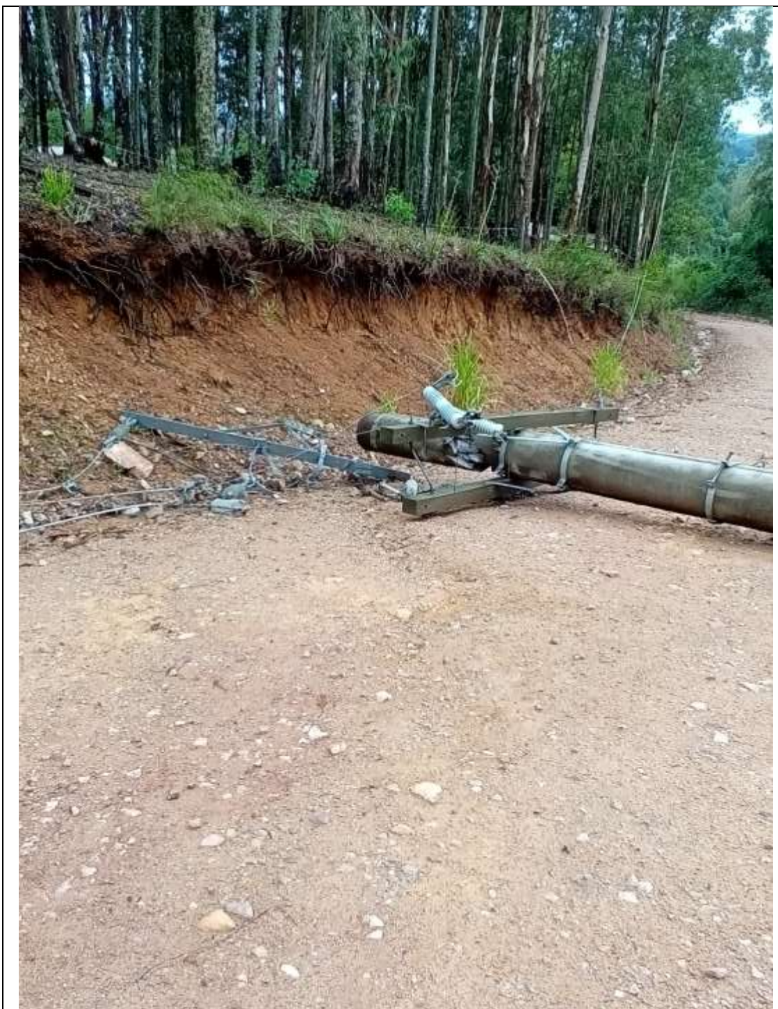
Foto 6 – Poste caído devido ao temporal em Dom Feliciano – RS
