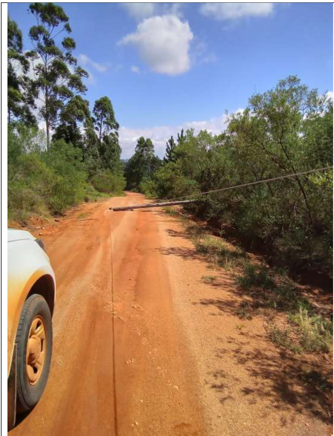
Foto 2 – Poste caído devido ao temporal em São Jerônimo – RS
