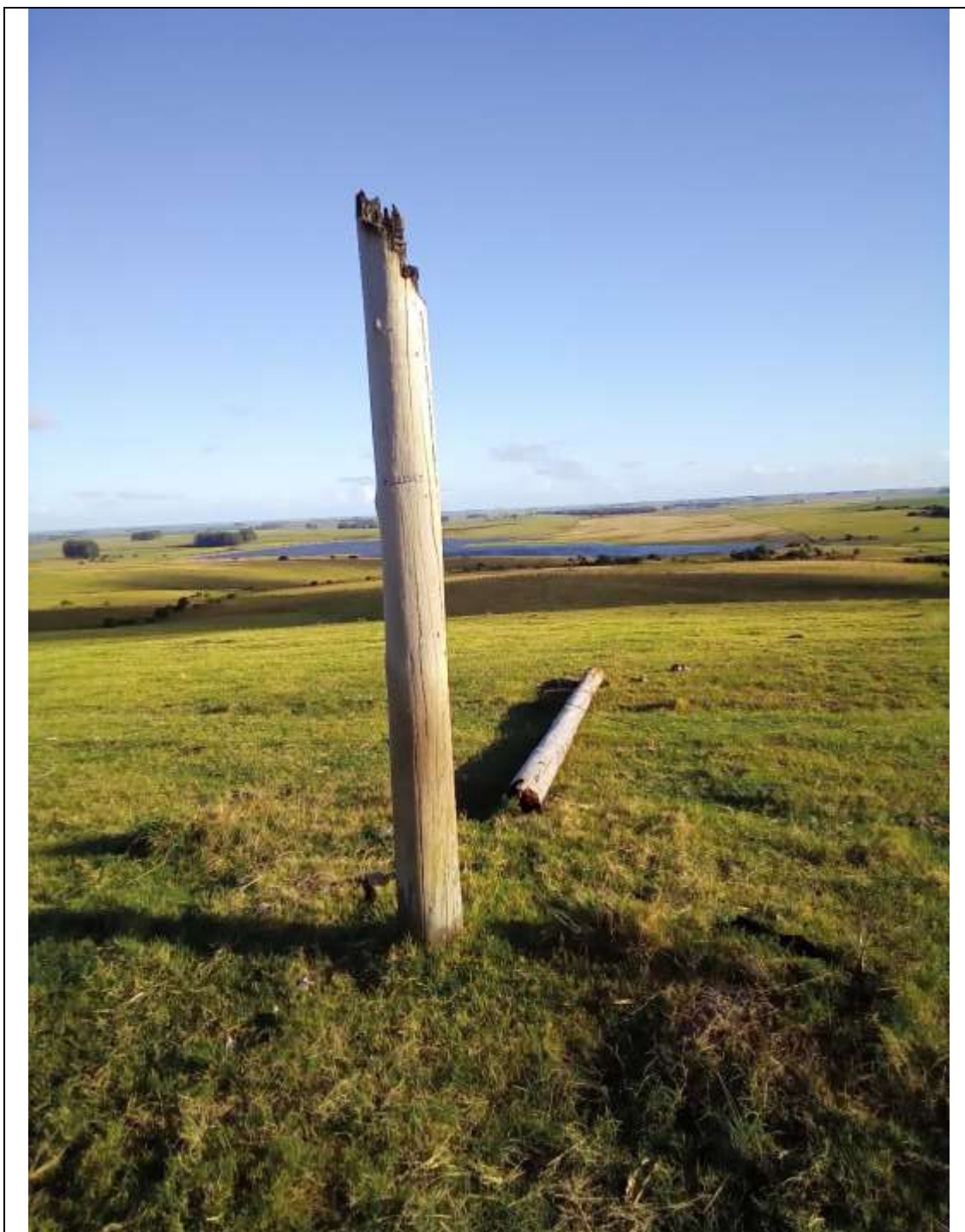
Foto 13 – Poste queimado devido ao temporal em Arroio Grande – RS
