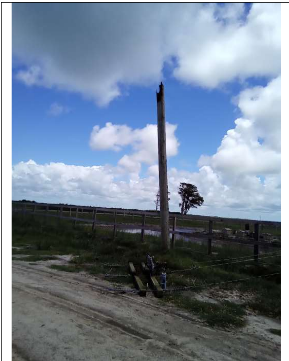
Foto 16 – Poste queimado devido ao temporal em Arroio Grande – RS
