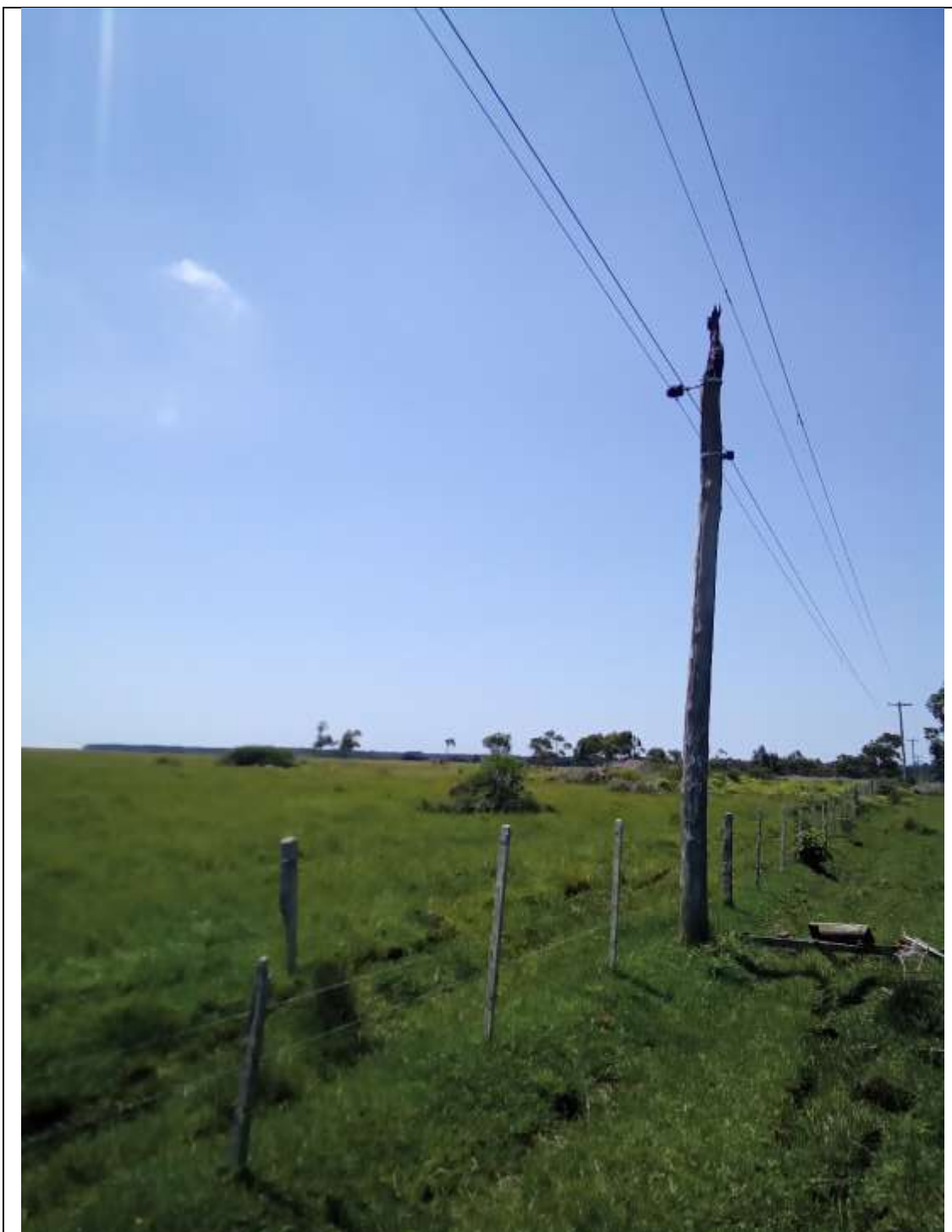
Foto 5 – Poste atingido por descarga atmosférica durante o temporal em Mostardas – RS
