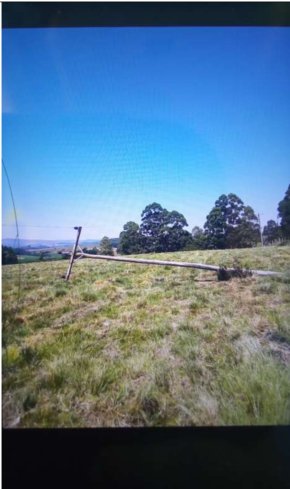
Foto 1 – Poste caído devido ao temporal em Butiá - RS
