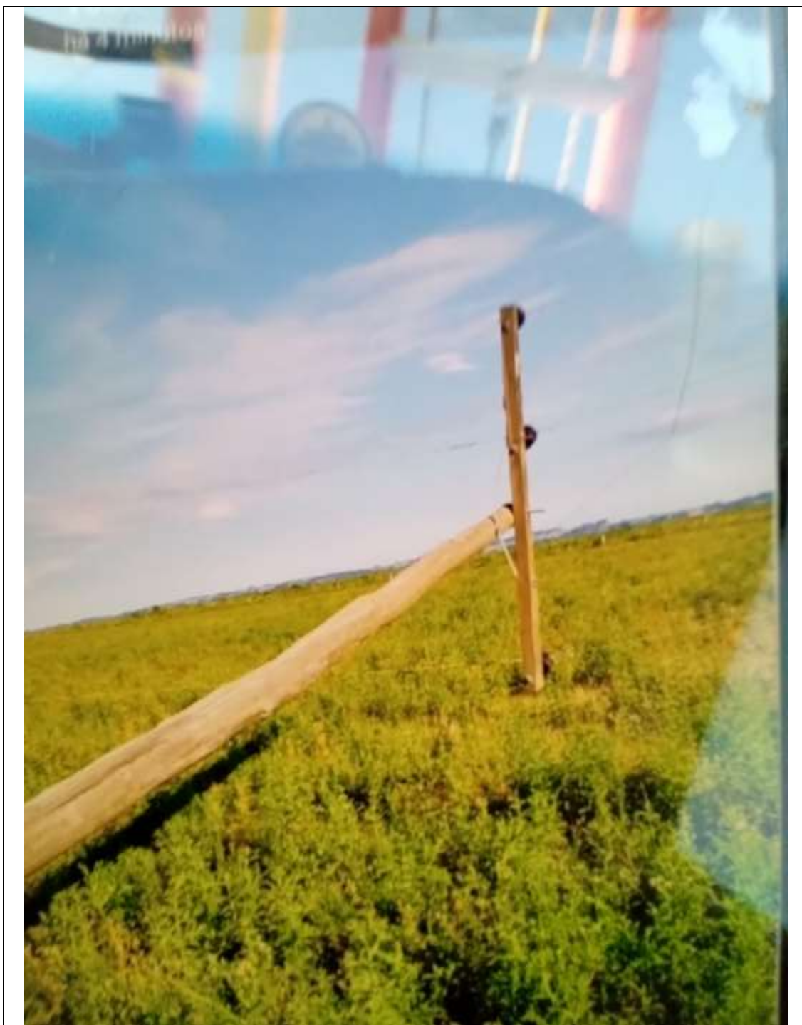
Foto 6 – Poste caído devido ao temporal em Santo Antônio da Patrulha – RS
