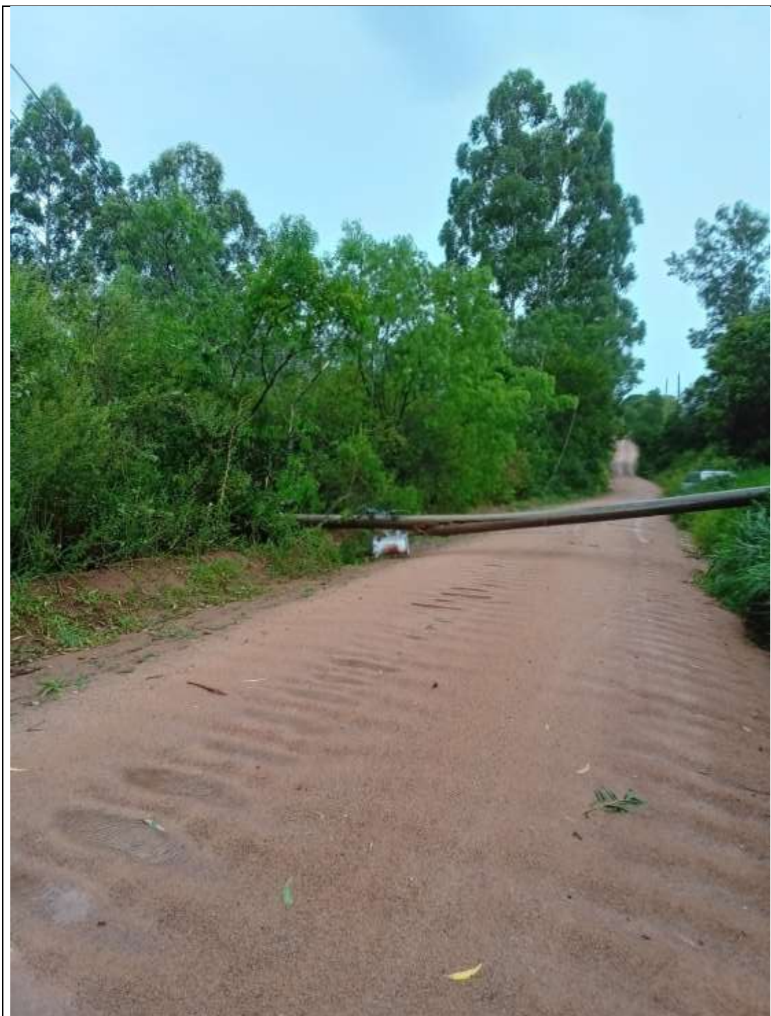
Foto 5 – Poste caído devido ao temporal em Dom Feliciano – RS
