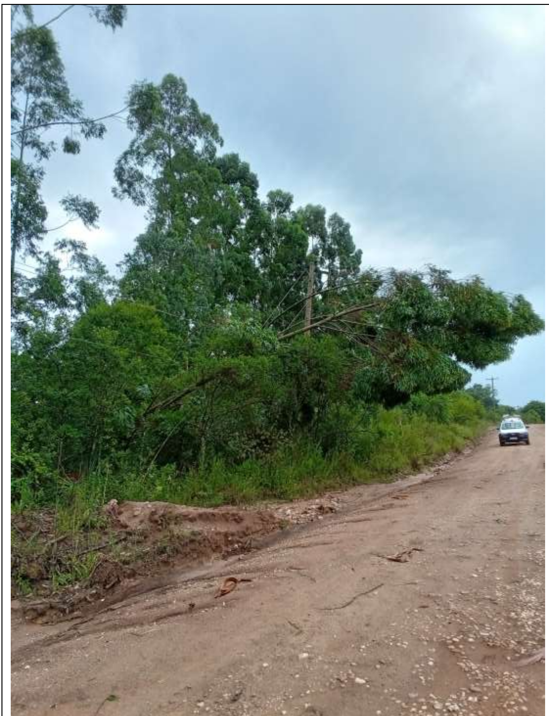
Foto 4 – Árvore caída sobre a rede devido ao temporal em Dom Feliciano - RS
