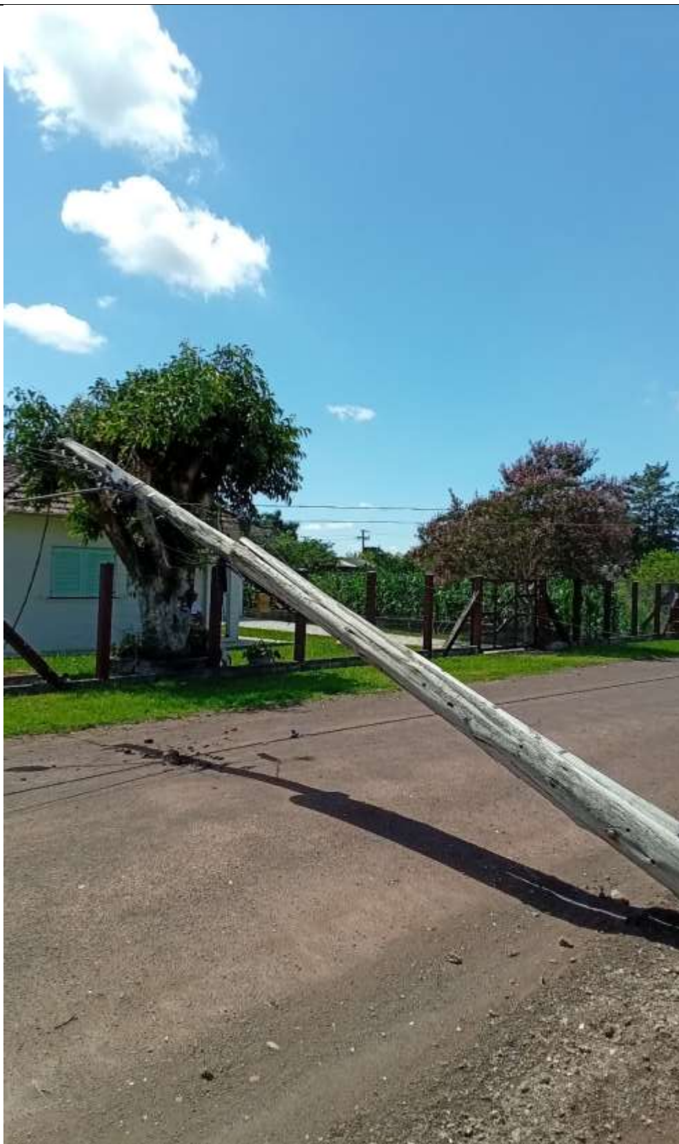
Foto 8 – Poste caído devido ao temporal em Santo Antônio da Patrulha – RS
