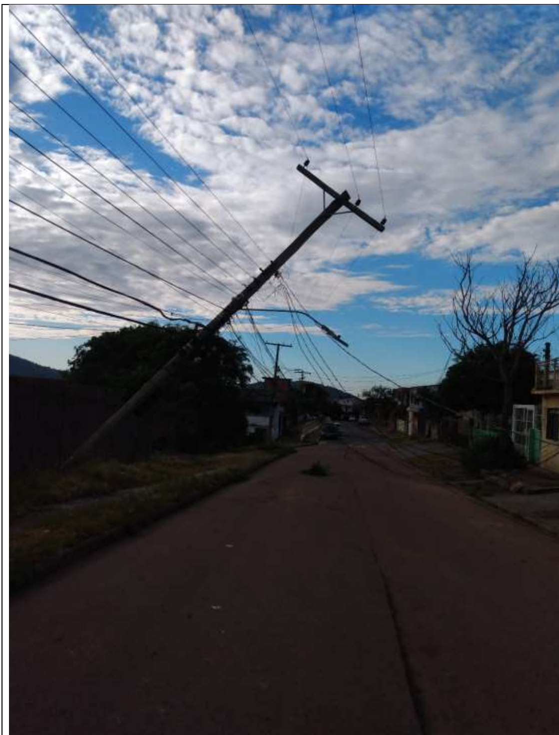
Foto 9 – Poste tombado devido ao temporal em Porto Alegre – RS
