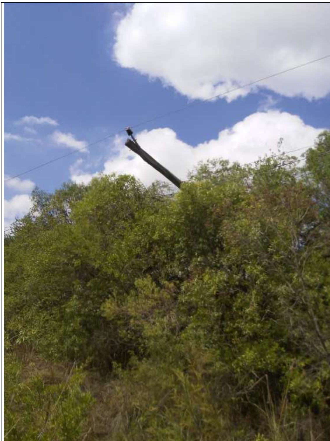
Foto 2 – Poste caído devido ao temporal em Dom Pedrito – RS
